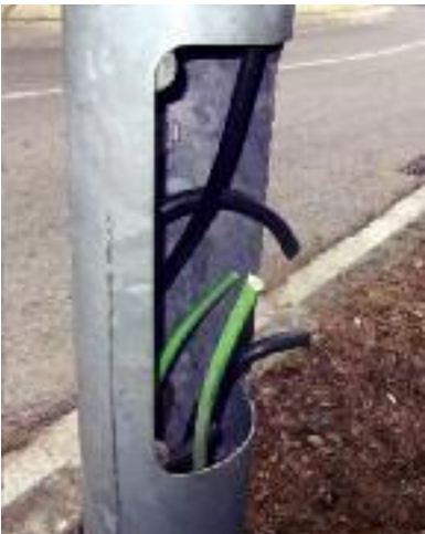
Un dels fanals amb els cables tallats ©Sece
