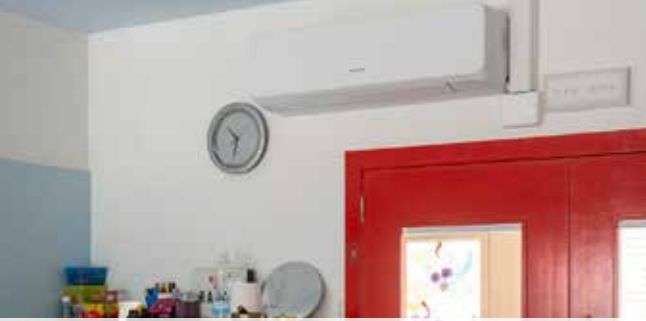
Un dels aires condicionats que s’han instal·lat a les aules. ©Miquel Badia
